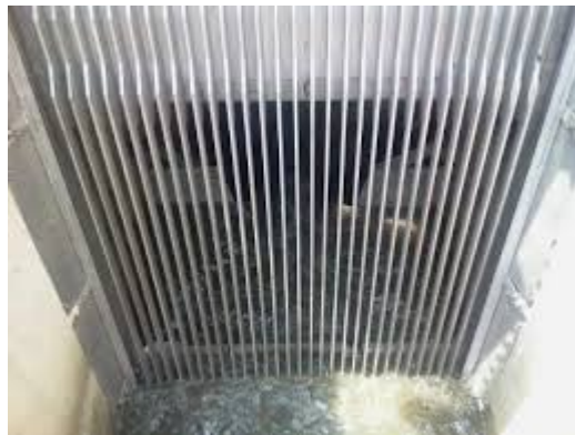
Figure 02: Grilles de dégrilleur.
