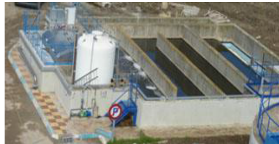
Figure 08: La zone de traitement tertiaire.
