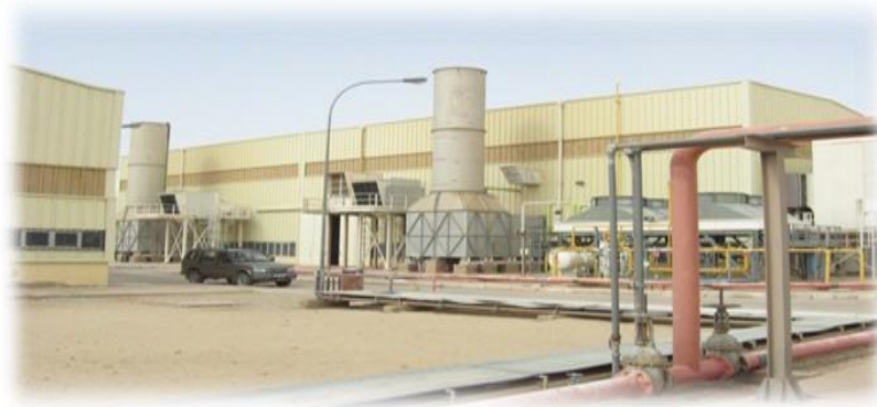
Figure I.18 : La turbine à gaz.
