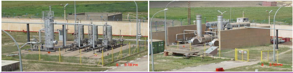
Figure I.6: Postes Gaz Et Chaudière..
