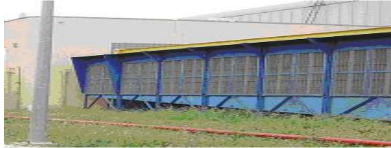
Figure I.3: Système de filtration d'air.
