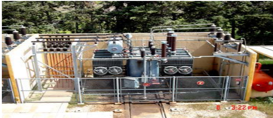
Figure I.4: Transformateurs principaux (TP) de 32 MVA.
