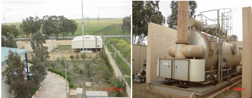
Figure I.11: Poste Gaz et Chaudière.
