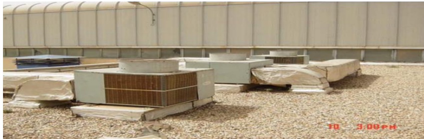
Figure I.7: groupes de climatisations.
