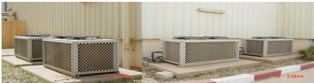
Figure 1.14 : groupes de climatisations.
