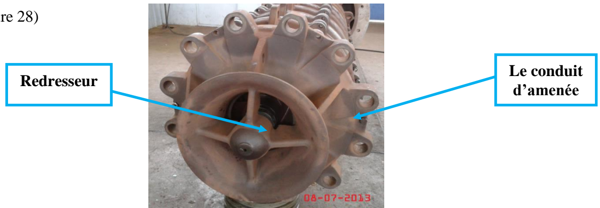
Figure 28 : Conduit d'amenée de la pompe
