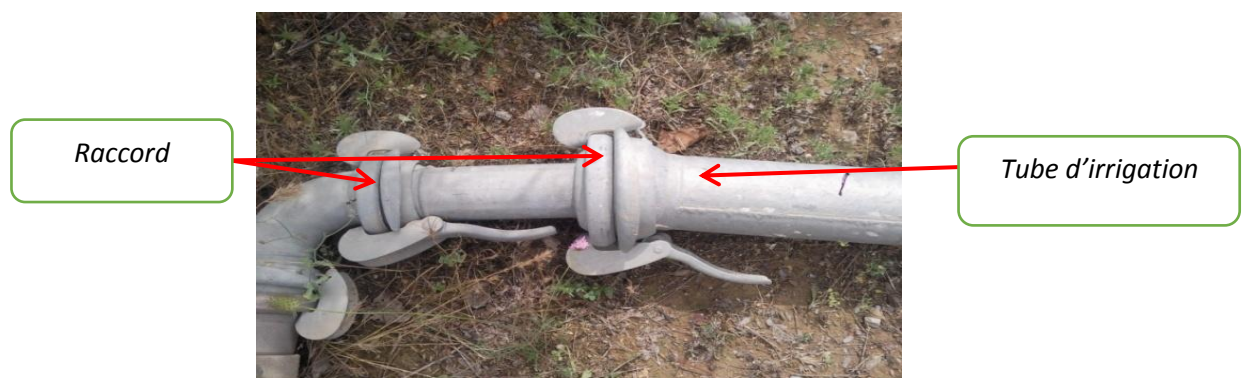
Figure II. 4 : Le raccord avec un tube d'irrigation.
