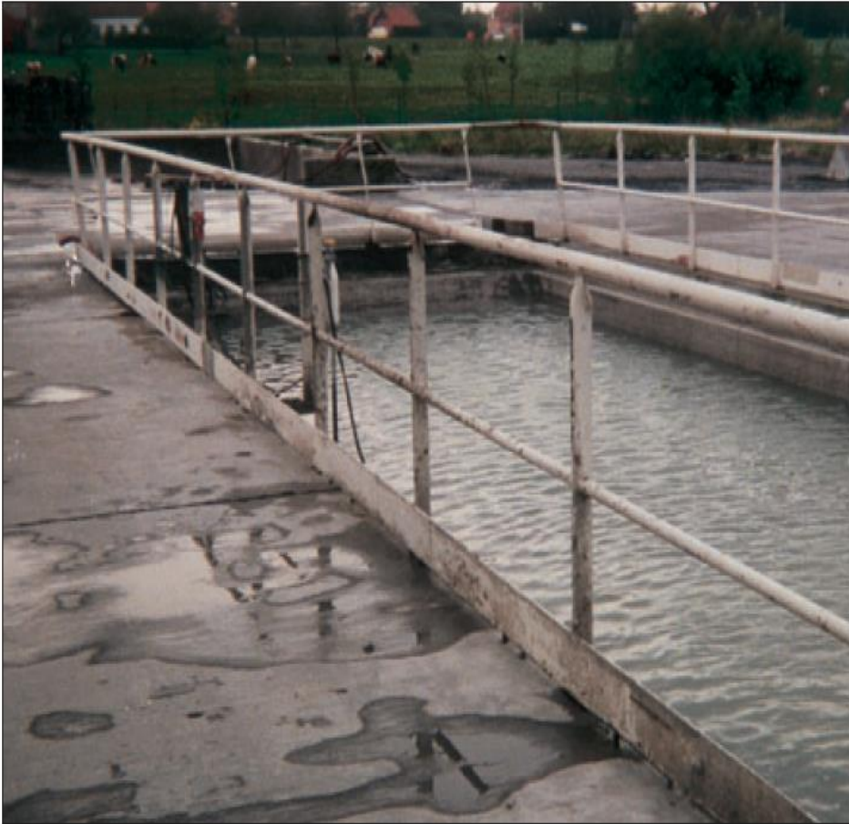
Figure III.2 : Photo du puits de la finition incorrecte des garde-corps.
