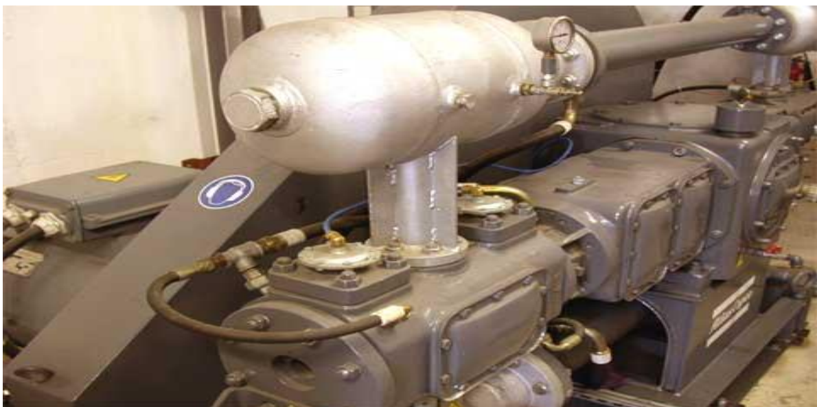
Figure III- 2 : Le compresseur ATLAS COPCO CREPELLE
