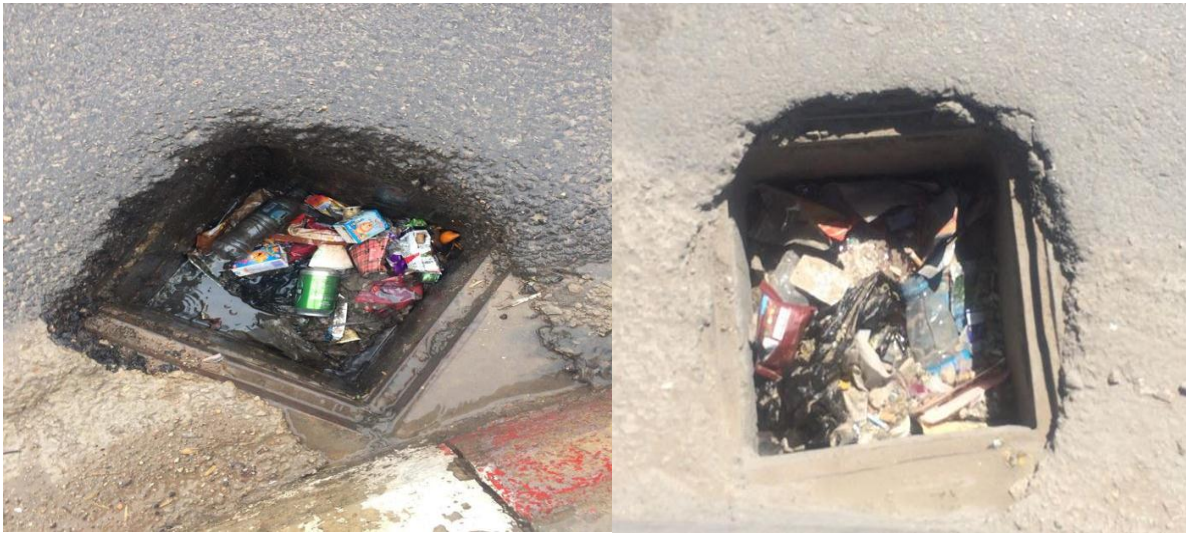
Figure 2 : Avaloirs colmatés remplient d'eau après averse CITE BADR Avril 2018.
