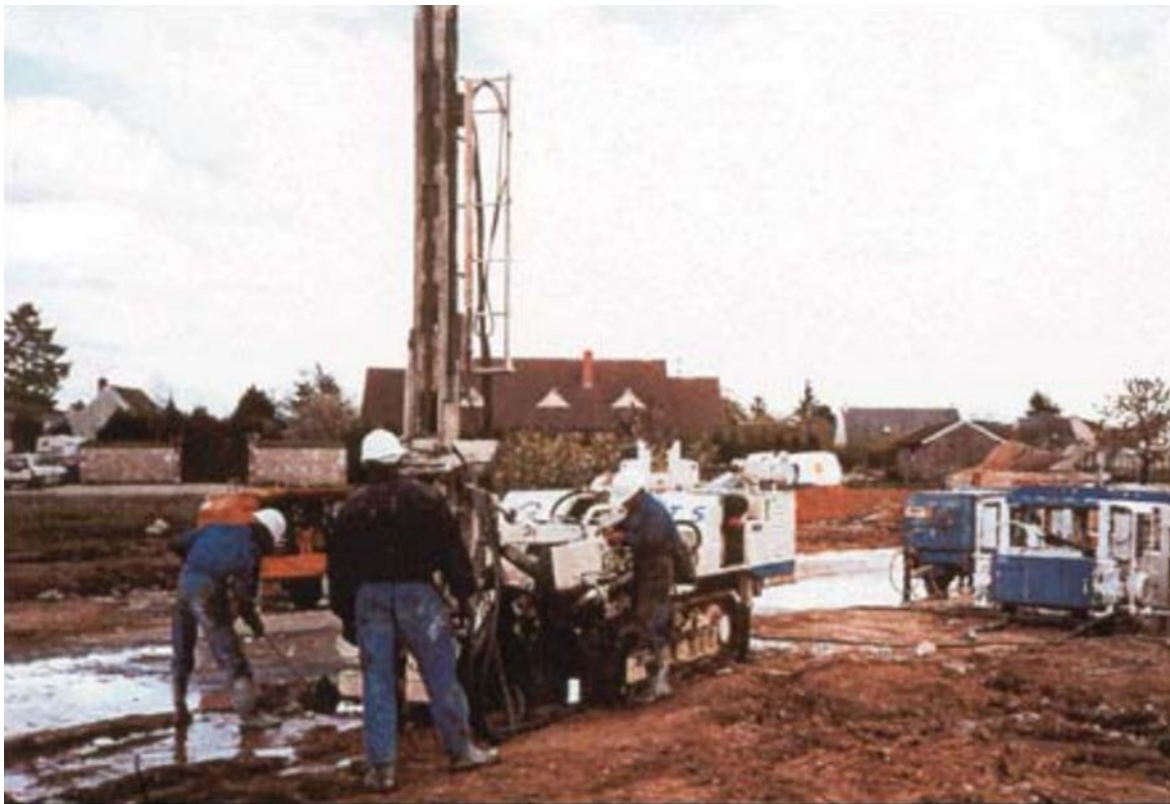
Atelier de forage et pompes d'injection
