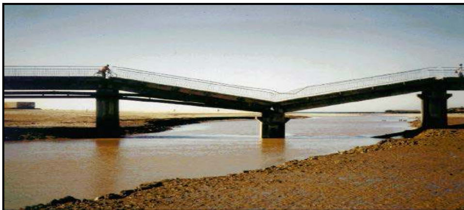
Figure 1.4 – Poinçonnement (enfoncement vertical) d'une pile de pont.
