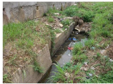
Obstruction partielle du canal
