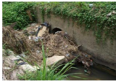
Obstruction d'une buse
