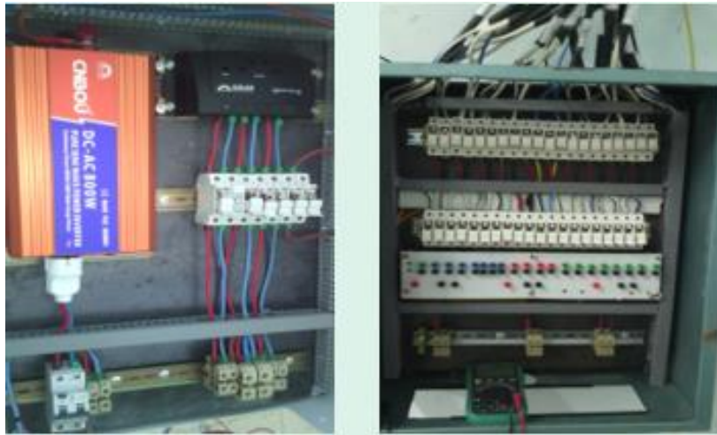
Figure IV.20. Armoire de commande du GPV
