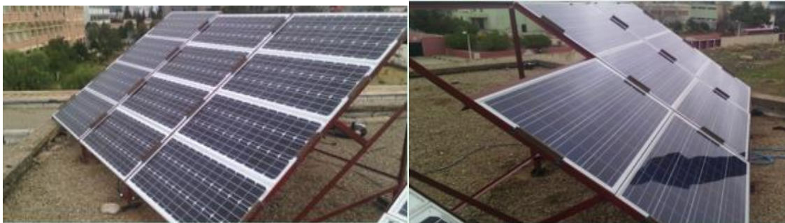
Figure IV.19. GPV installé au niveau du laboratoire L2GEGI
