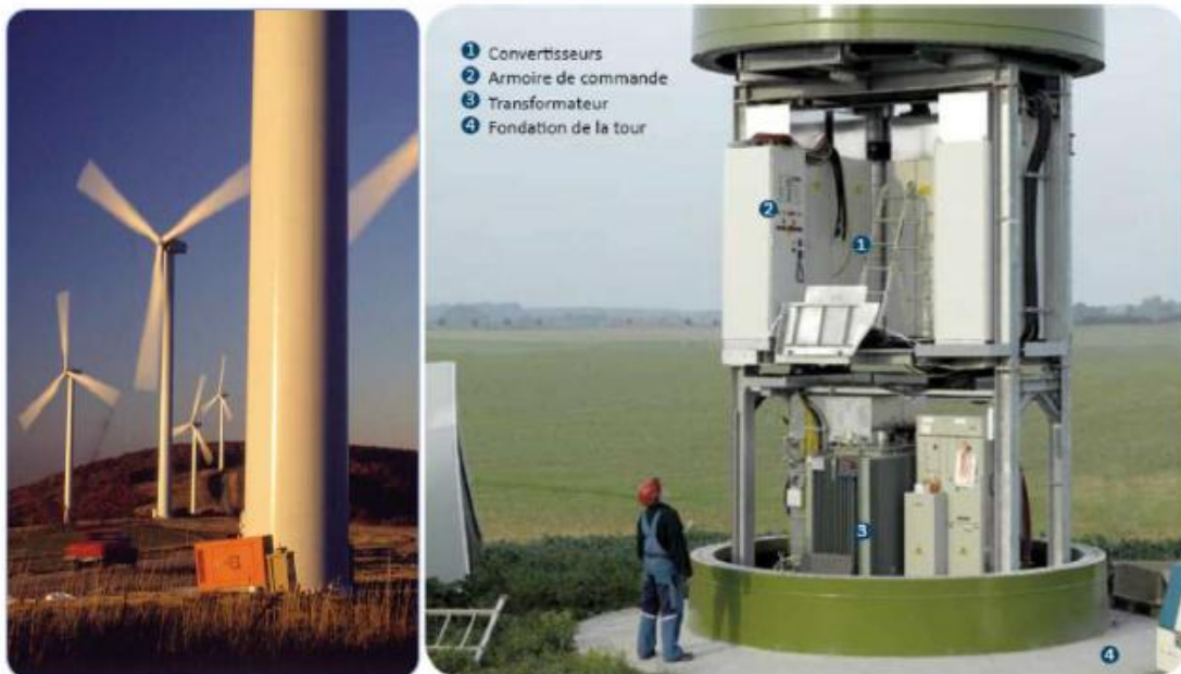
Figure.I.4 : La tour éolienne et ses composants électroniques à l'intérieur.
