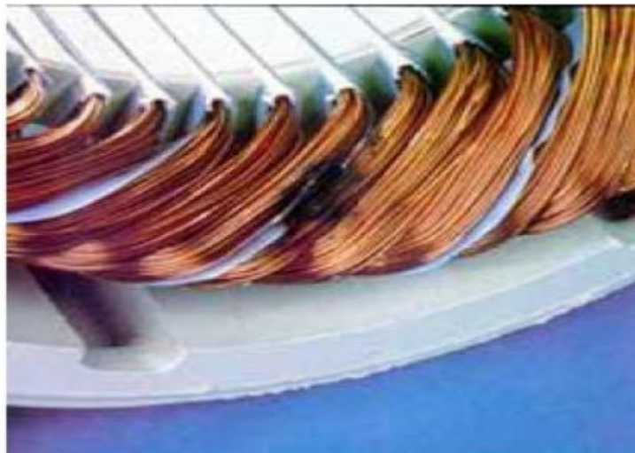
Figure (I.07): Défaut de court-circuit entre phases
