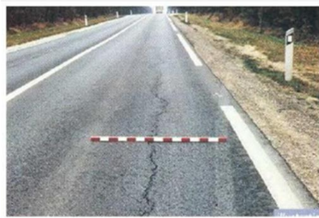
Fig.(I.23) Fissuration longitudinale dans une bande de roulement [LCPC, 1998][7]
