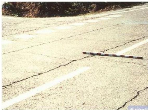
Fig.(I.24) Fissure en dalle [LCPC, 1998][7]
