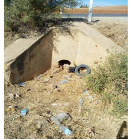
Ouvrage busé PK 125+800 côté gauche, \varnothing 600 ; mal entretenu
