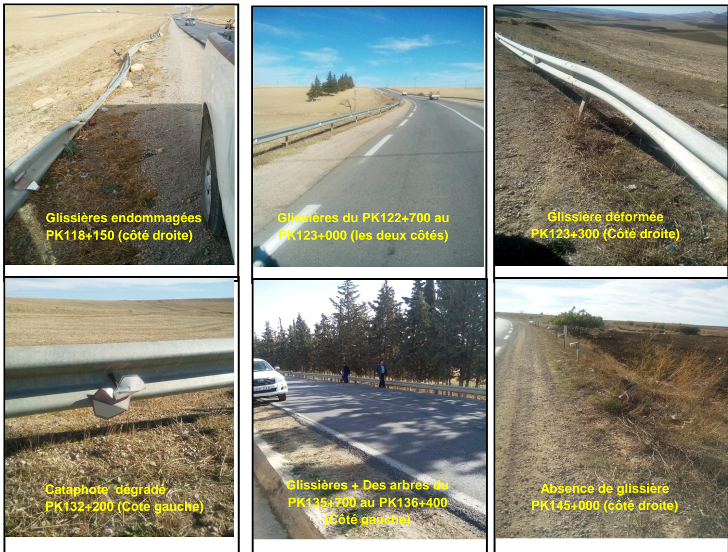
Fig.(III.24) Etat des Glissières sur le tracé investigué.
