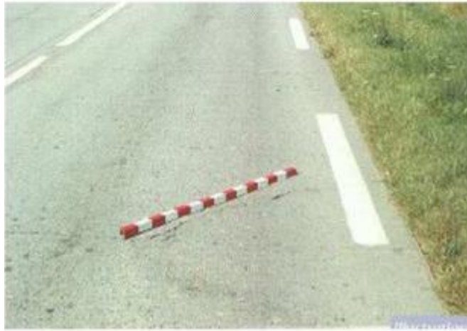
Fig.(I.29) Fissure oblique de la dalle [LCPC, 1998][7]
