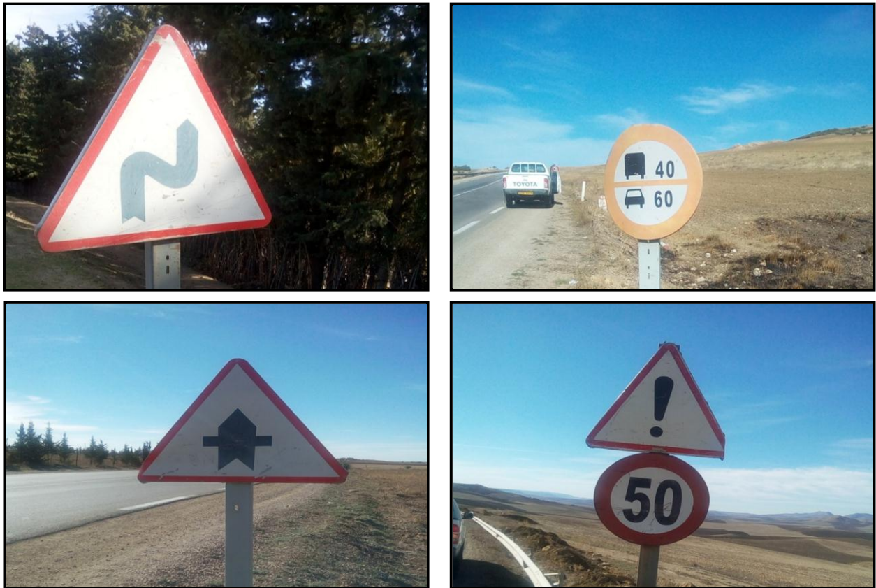
Fig.(III.22) Panneaux de la signalisation verticale en état moyen.
