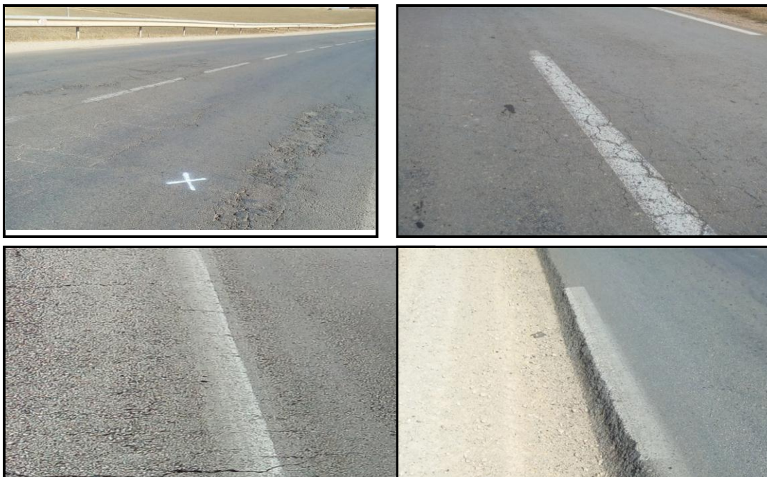
Fig.(III.20) L'état de la signalisation horizontale.
