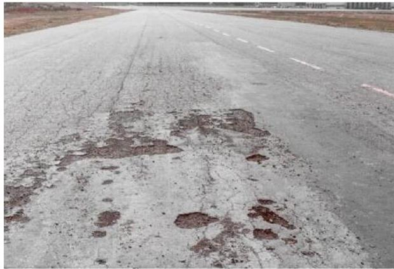
Fig.(I.5) dégradations d'arrachement
