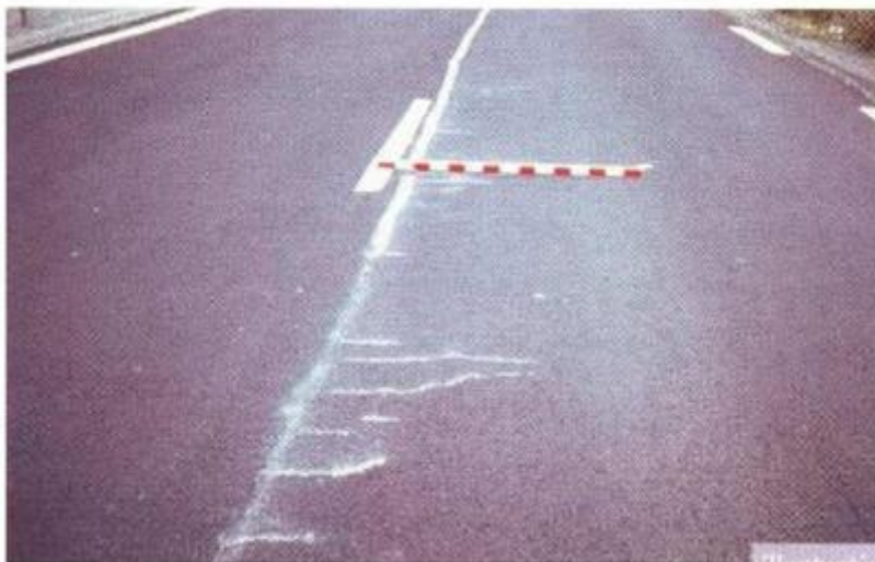
Fig.(I.12) Remonté des fines : dégradation franche, significative et étendue
