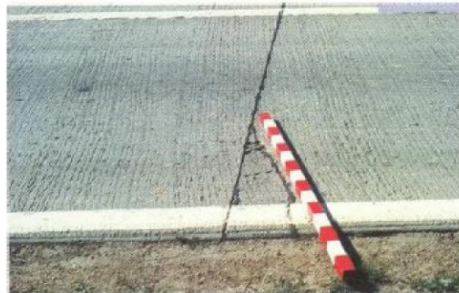
Fig.(I.28) Cassure d'angle : cassure dégradée avec départ de matériaux - LCPC
