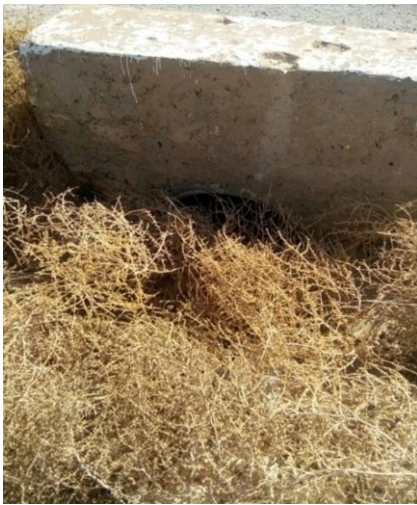
Ouvrage busé PK 144+150 côté droit, D = \varnothing 1000 ; mal entretenu
