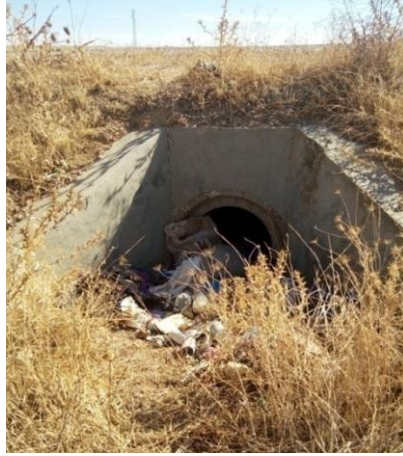
Ouvrage busé PK 122+150 côté droit, \varnothing 600 , mal entretenu
