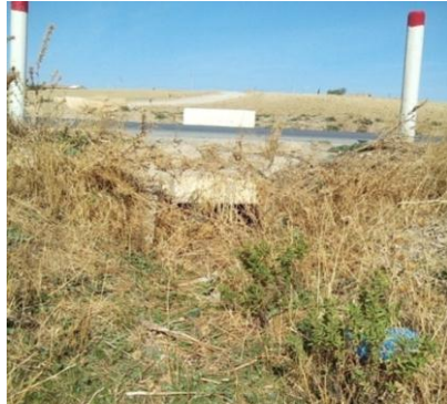
Dalot PK 139+300 côté gauche D = 1.00x1.00 ; mal entretenu et la tête dégradée
