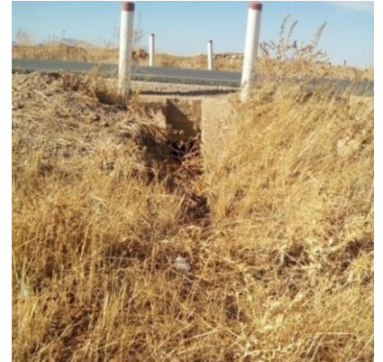
Dalot PK 128+600 côté gauche D = 0.50x0.50 ; mal entretenu
