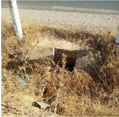
Dalot PK 127+900 côté droit D = 0.50x0.50 mal entretenu
