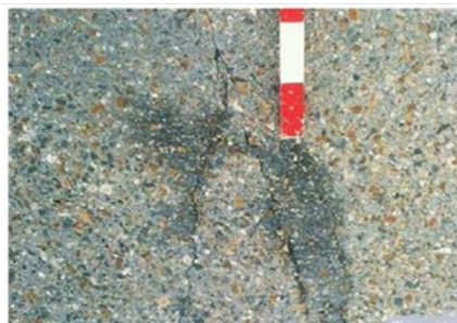
Fig.(I.26) Fissure diverse en Y dans la chaussée en béton [LCPC, 1998][7]
