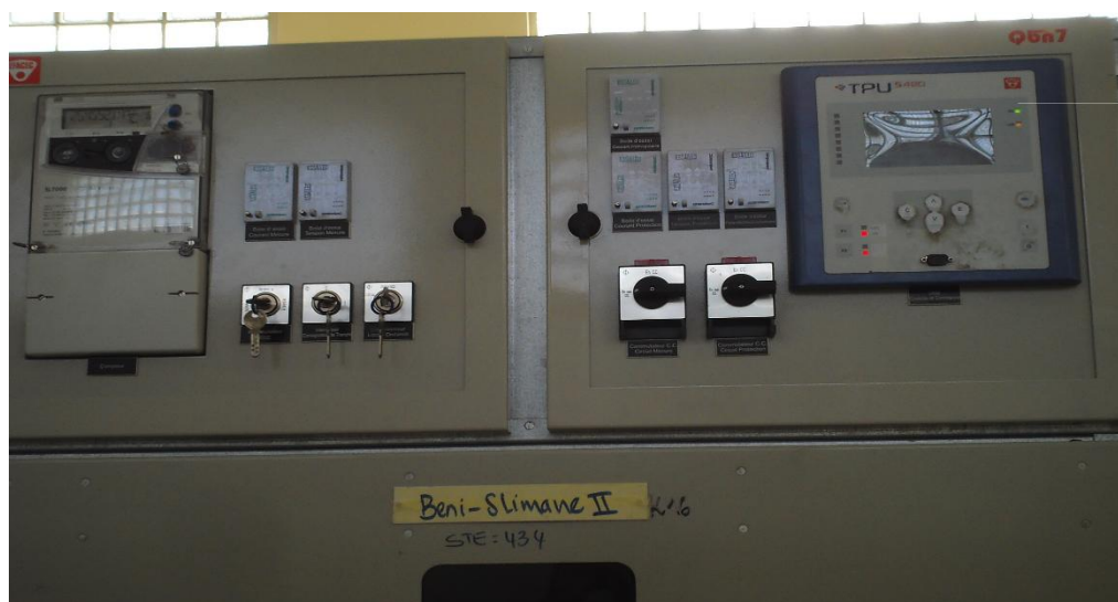
Fig. 03 : appareil de protection utilisé sur les départs MT.
