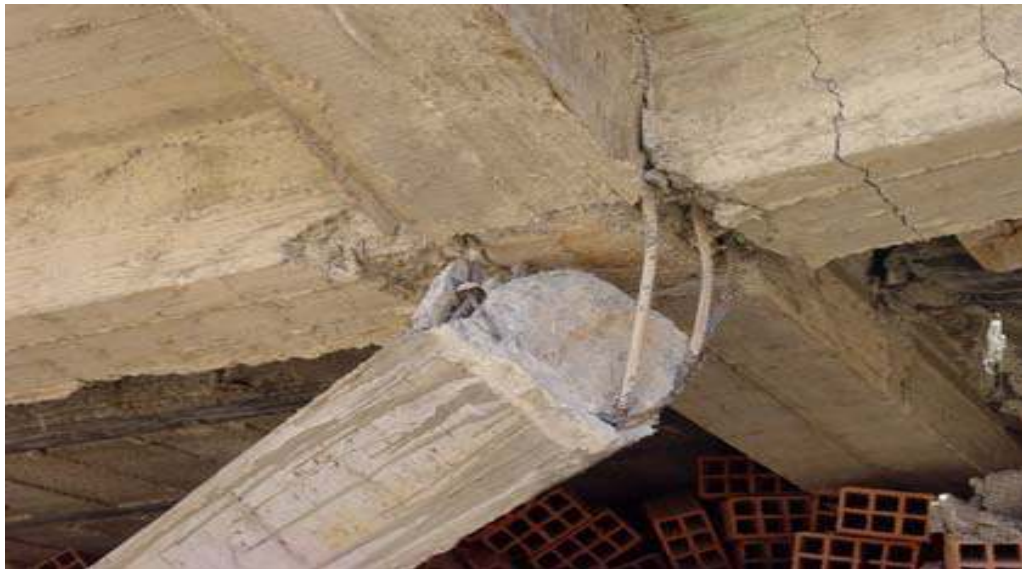
Photo III.19 Séisme Boumerdès 2003- rapport préliminaire V.DAVIDOVIDCI.
