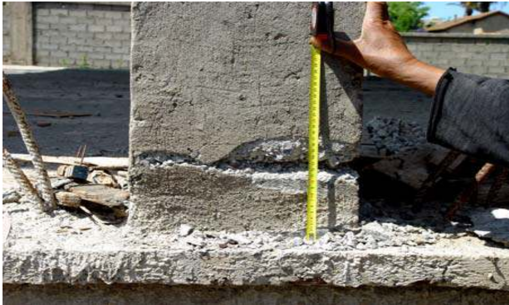
Photo III.17 Séisme Boumerdès 2003- rapport préliminaire V.DAVIDOVIDCI. Talonnette de 10 cm en mortier de très mauvaise qualité.
