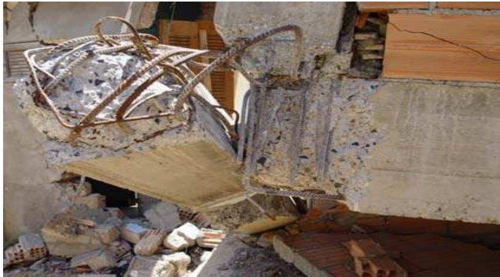
Photo III.16 Séisme Boumerdès 2003- rapport préliminaire V.DAVIDOVIDCI.
