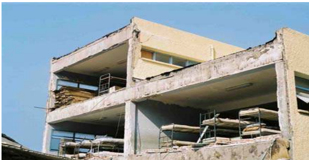
Photo III.20 Rapport AFPS bâtiment dont les poutres sont dimensionnées plus largement que les poteaux, la rupture des têtes de poteaux pourrait entraîner la ruine totale pour des secousses plus violentes.
