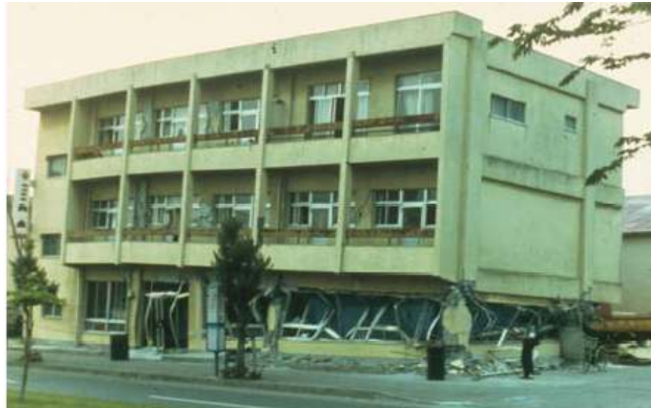
Photo III.9 Document NISEE – et Séisme de Kobé, 1995, L'excentrement entre le centre de gravité et le centre de rigidité a provoqué la torsion du bâtiment.
