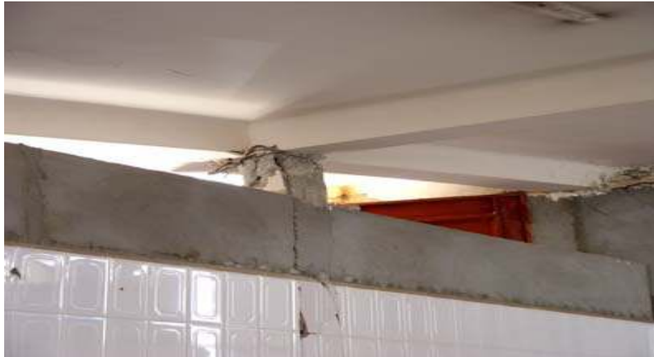
Photo III.5 Séisme Boumerdès 2003- rapport préliminaire V.DAVIDOVIDCI
