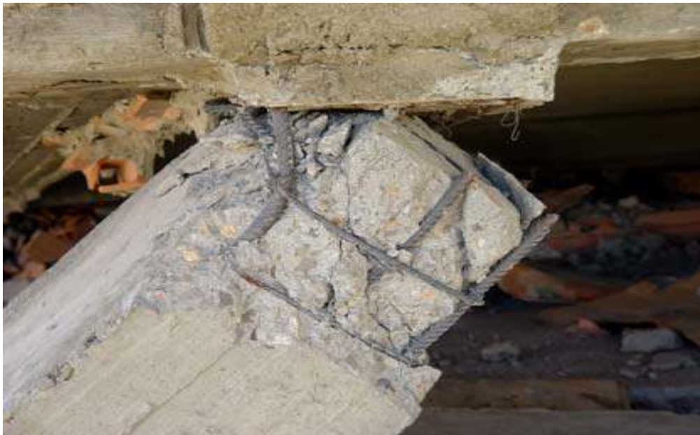
Photo III.18 Séisme Boumerdès 2003- rapport préliminaire V.DAVIDOVIDCI. Insuffisance d'armatures transversales, béton de mauvaise qualité, rupture au droit de la surface de reprise.
