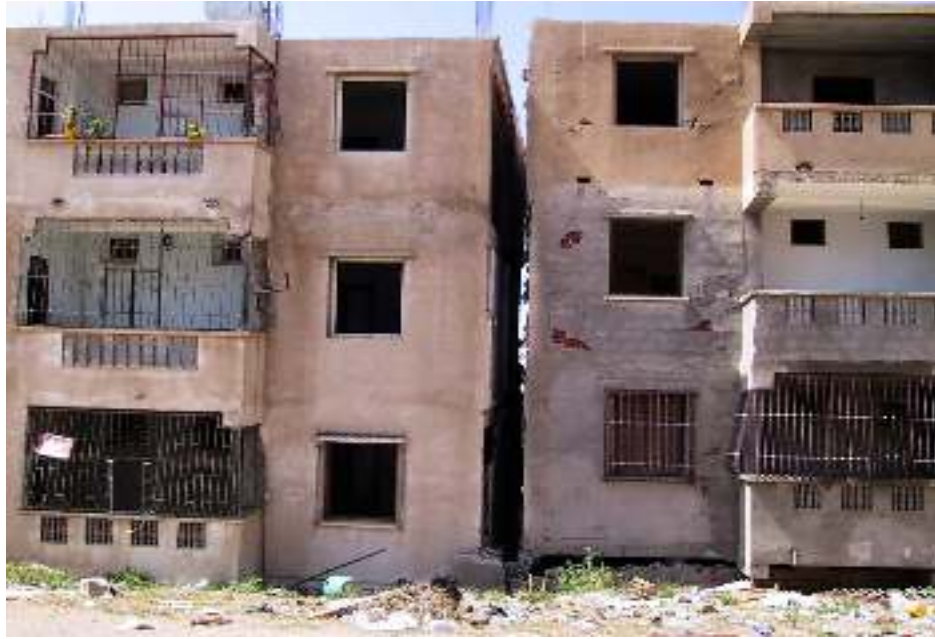
Photo III.7 Cisaillement des poteaux courts au niveau du vide sanitaire.
