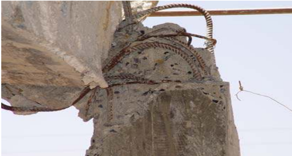
Photo III.14 Séisme Boumerdès 2003- rapport préliminaire V.DAVIDOVIDCI. Destruction de l'extrémité du poteau du fait de l'absence d'armatures transversales dans la zone critique du poteau
