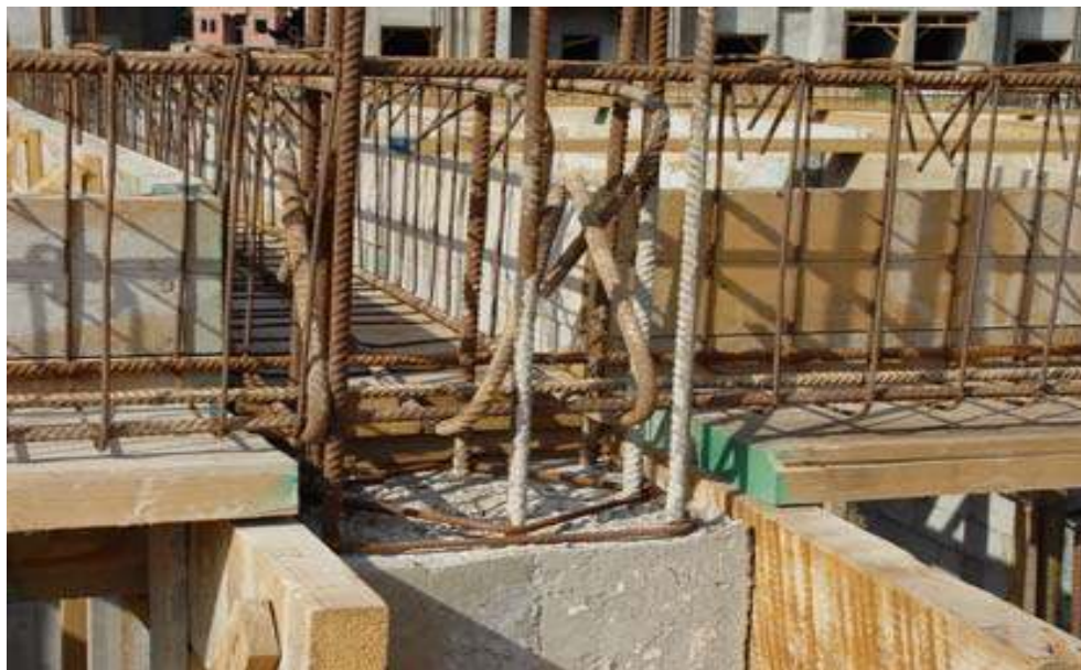
Séisme Boumerdès 2003- rapport préliminaire V.DAVIDOVIDCI. Arrêt du coulage du poteau à environ 5cm sous la sous face de la poutre. Absence d'armatures transversales dans le nœud.
