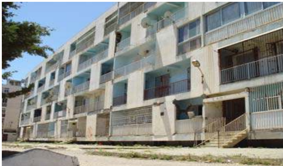
Photo III.13 Séisme Boumerdès 2003- rapport préliminaire V.DAVIDOVIDCI. Porte-à-faux bas du RdCh. au-dessus d'un sous-sol en retrait
