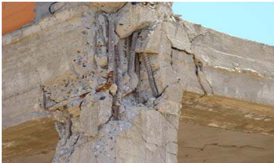
Photo III.15 Séisme Boumerdès 2003- rapport préliminaire V.DAVIDOVIDCI. Effondrement à cause de l'absence d'armatures transversales dans le nœud et dans la zone critique du poteau.
