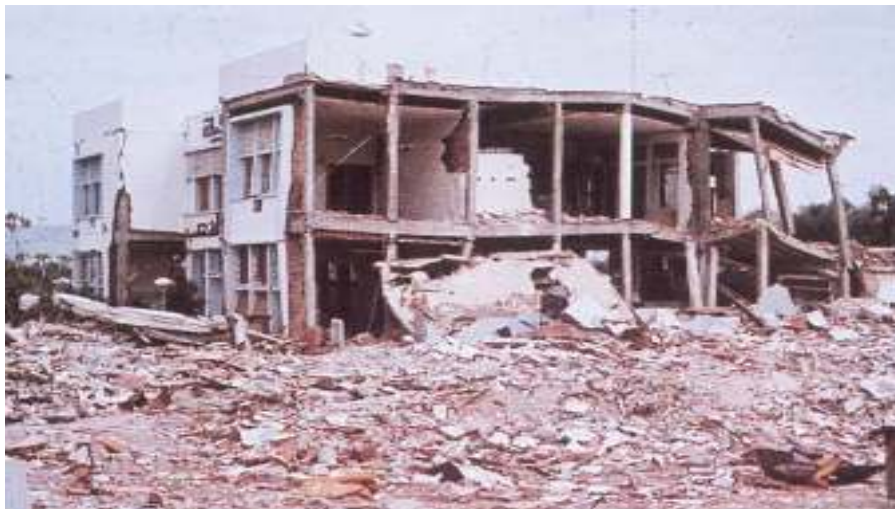
Photo III.3 Eclatement des remplissages de maçonnerie d'une structure de béton armé (Séisme d'El Asnam) [11] .
