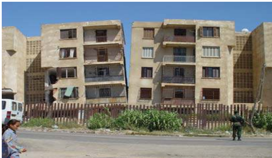
Photo III.8 Séisme Boumerdès 2003- rapport préliminaire V.DAVIDOVIDCI.
