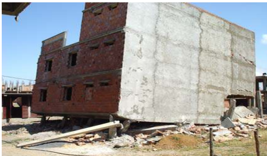
Photo III.4 Séisme Boumerdés 2003- rapport préliminaire V.DAVIDOVIDCI.
