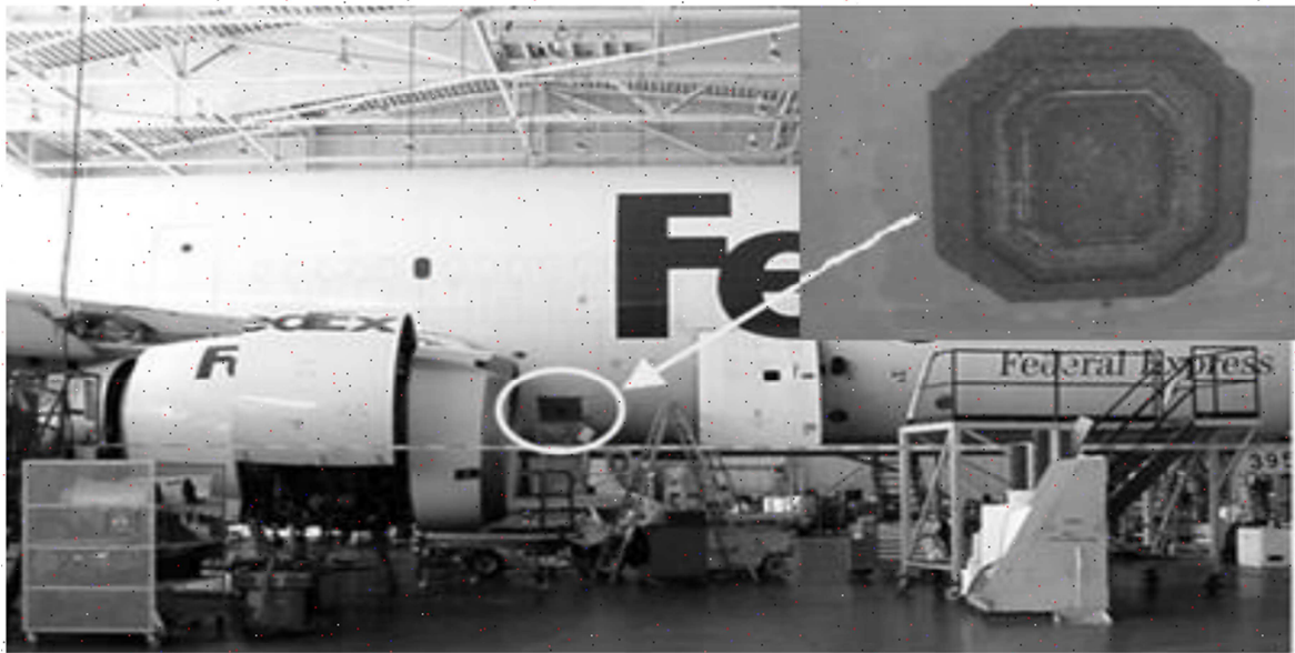
Figure II.3.9. Réparation par patch en composite des fuselages aéronautiques 395[62].
