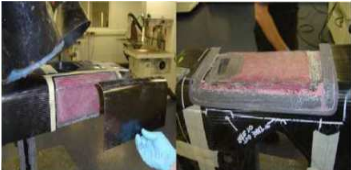
Figure II.3.2: Réparation d'un châssis du véhicule F1 par patches composites.
