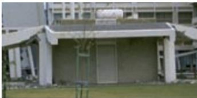
Figure 1.8 : Rupture de porte-à-feu, siesme Californie 1971
