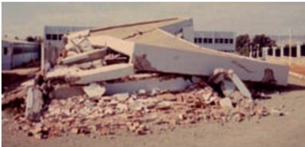
Figure 1.9: Effondrement dû à la torsion, El Asnam 1980
