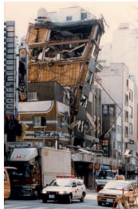
Dommages dus à la résonance du bâtiment avec le sol (Kobé, Japon 1995)
