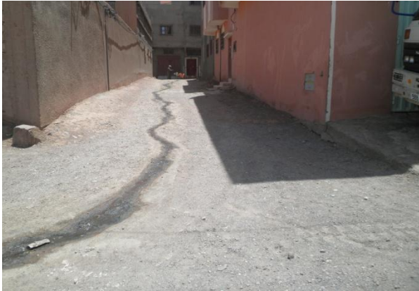
صورة رقم 8: غياب الصرف الصحي
